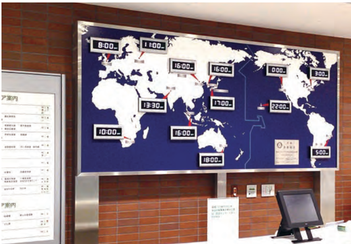
▲東広島市役所／広島県東広島市 ※WDC-402×13台使用(枠、世界地図はお客様にてご用意)
