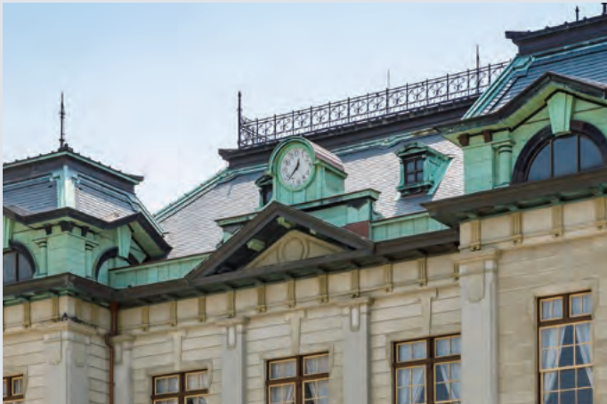
▲門司港駅／福岡県北九州市 φ1,000 LED内部照明付(文字板)
